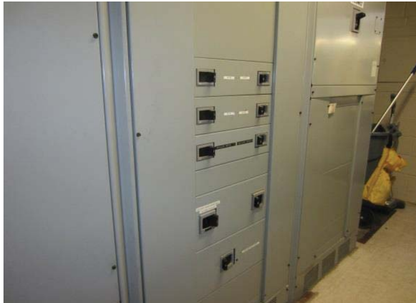
Existing 480Y/277 volt switchboard
